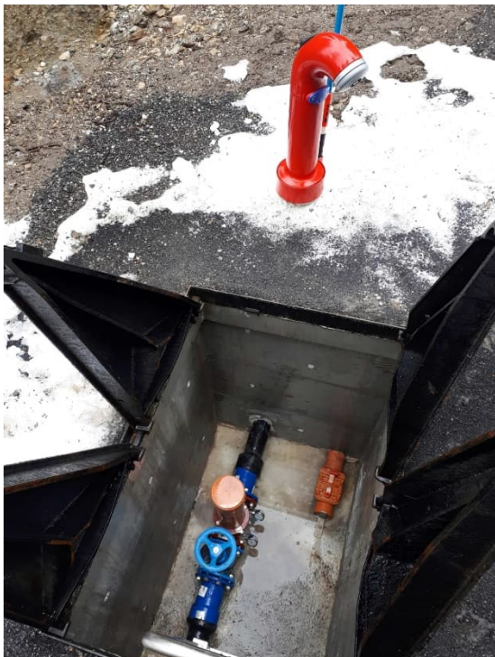
Place des Pueys : nouvelle chambre de réduction et borne d'hydrante
