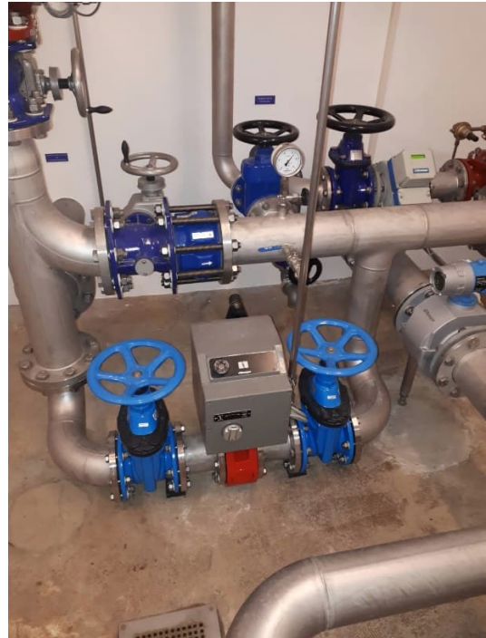
Réservoir Rosalys : nouvelle vanne incendie, secteur les Pueys
